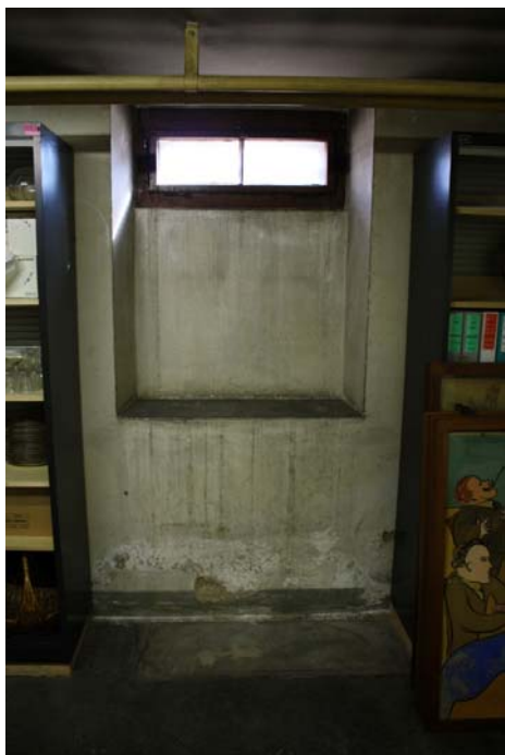
Rückstände von herabfliessendem Wasser. Feuchtes und bröselndes Mauerwerk, weissen Ausblühungen
