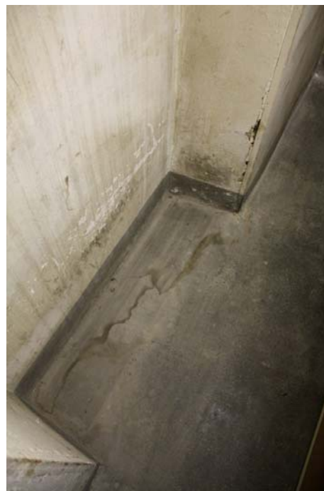
Eingetrocknete Wasserränder am Boden unter dem hintersten, abgedeckten Kippfenster.
