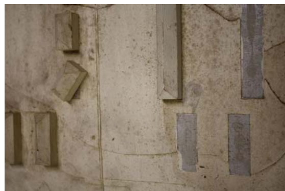
Detail: Fehlende Häuser, verschmutzte Oberfläche.
