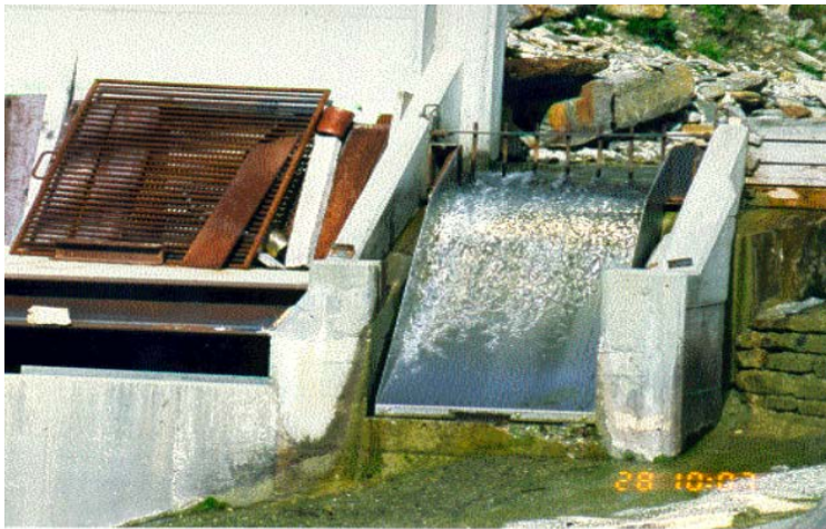
Abbildung 4: Pilotprojekt Coanda-Rechen am Rappierbach bei Hinterrhein GR. Erster Coanda-Rechen in der Schweiz. Inbetriebnahme 1998
