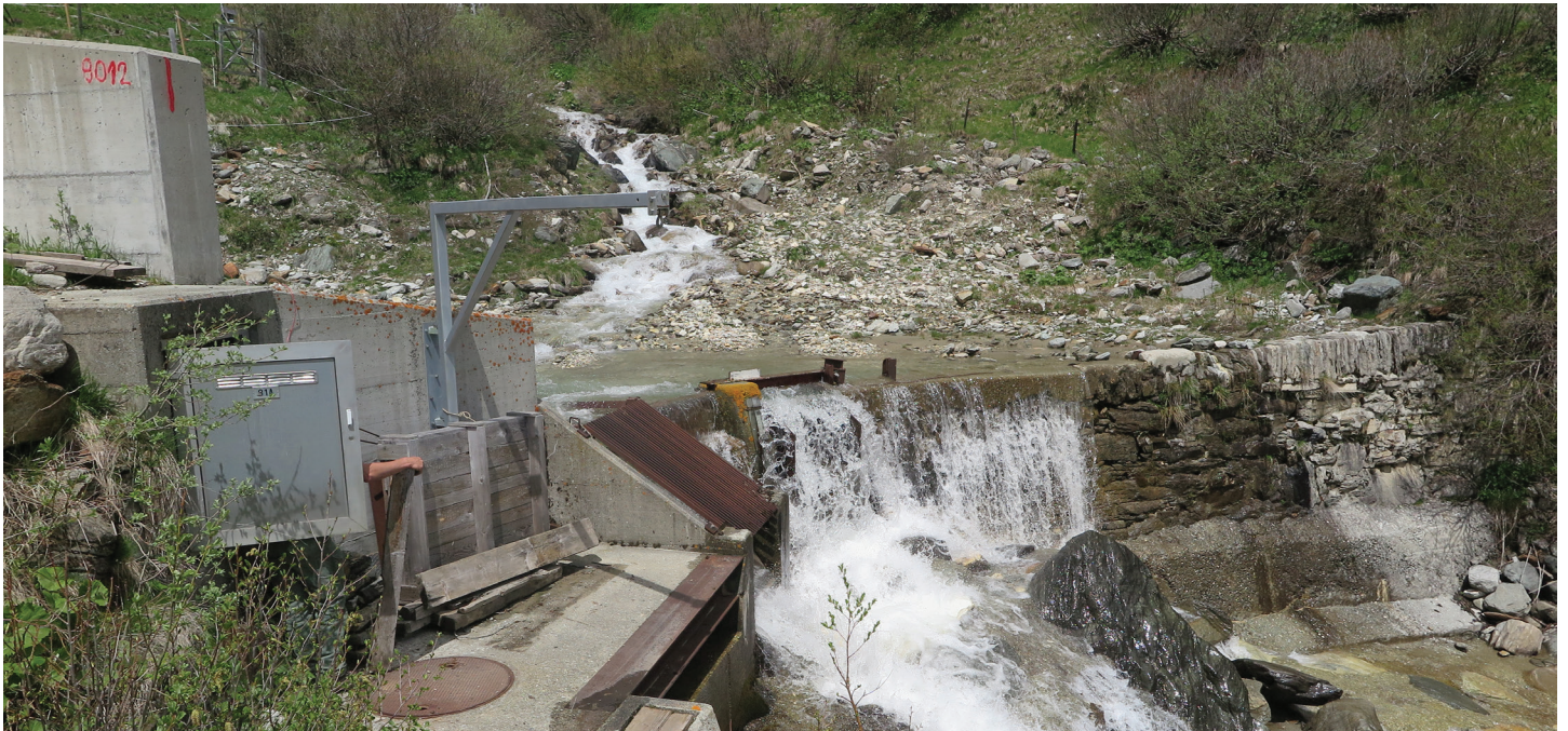
Der erste Coanda-Rechen der Schweiz kam 1998 am Rappierbach in der Gemeinde Hinterrhein (GR) zum Einsatz. Der Stababstand des einen Meter breiten Rechens beträgt 1 mm, die Schluckfähigkeit 140 l/s. Auf dem Bild liegt der Coanda-Rechen unterhalb des Schutzrostes versteckt. Der Rost dient dazu, bei Hochwasser grosse Steine vom Coanda-Rechen fernzuhalten. Foto: HTW Chur
