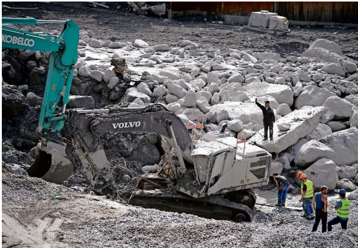
Sicherheit geht vor: Der Geschiebefang in Bondo wird vom Bergsturzmaterial und von einem mitgeschwemmten Bagger befreit. (FOTOS KEYSTONE)
